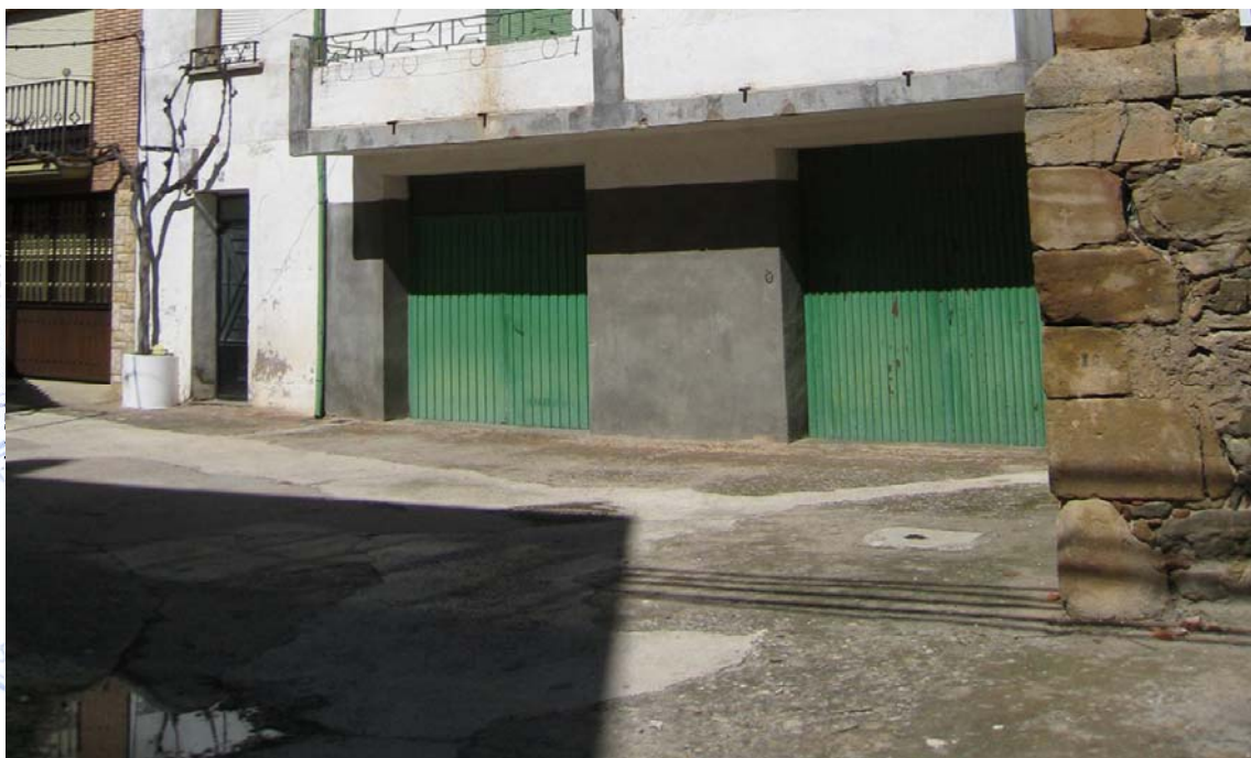
Ejemplo de pavimentaciones inadecuadas, en el entorno de la Iglesia de Magaña.
